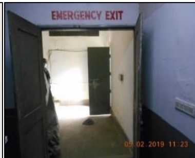
Abatere: ușa de urgență se deschide doar înspre interior, lipsește lumina
