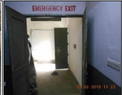
Non-conformité : porte intérieure ouverte et pas d'éclairage de secours
