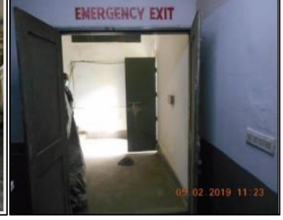
Uygunsuzluk: İçeri doğru açılan acil çıkış kapısı + tehlike durumu aydınlatmasının olmaması
