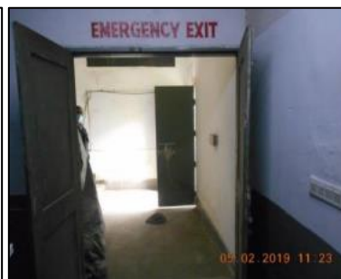
Niezgodność: Drzwi otwierane do wewnątrz + brak oświetlenia ewakuacyjnego
