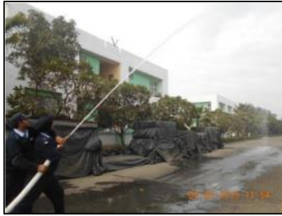
Fire Hose Testing 消防 水带测试
